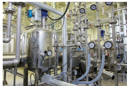
ジャケット保温されている製品保存用タンク
